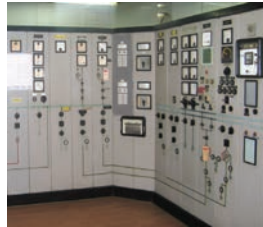
upravljanje i signalizacija
